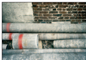
© INRS Canalisation en amiante
